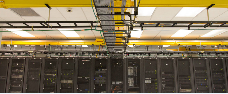
Webair NY1 Datacenter
